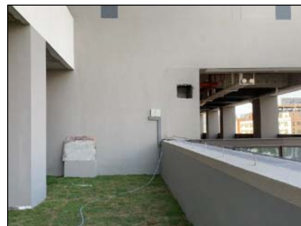
发电机烟气排放管道
