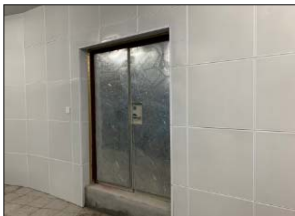
发电机房吸声门墙
